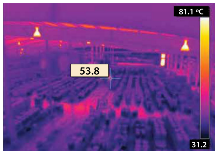
Kolejne zdjęcie z tego samego obszaru pokazuje kolejny wzrost temperatury w tym samym miejscu, doprowadzając do uruchomienia alarmu.
